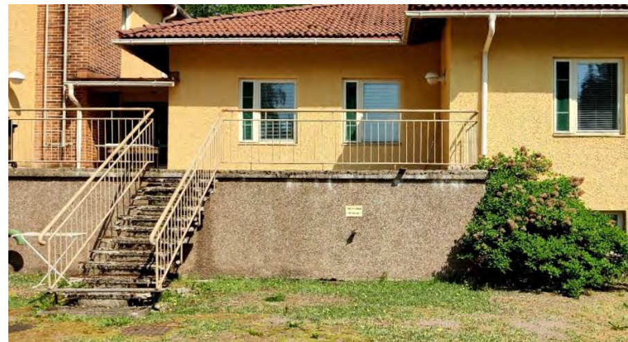
Kuva 89. Talo C, eteläpuolella olevan terassin taso on nostettu, portaiden paikka ja kaidetyyppi on muutettu alkuperäisestään.
