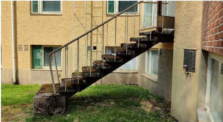
Kuva 75. Talo B, ulkoporras 1. kerroksen oleskelutilaan. Portaat ovat vaurioituneet vuosien varrella.
