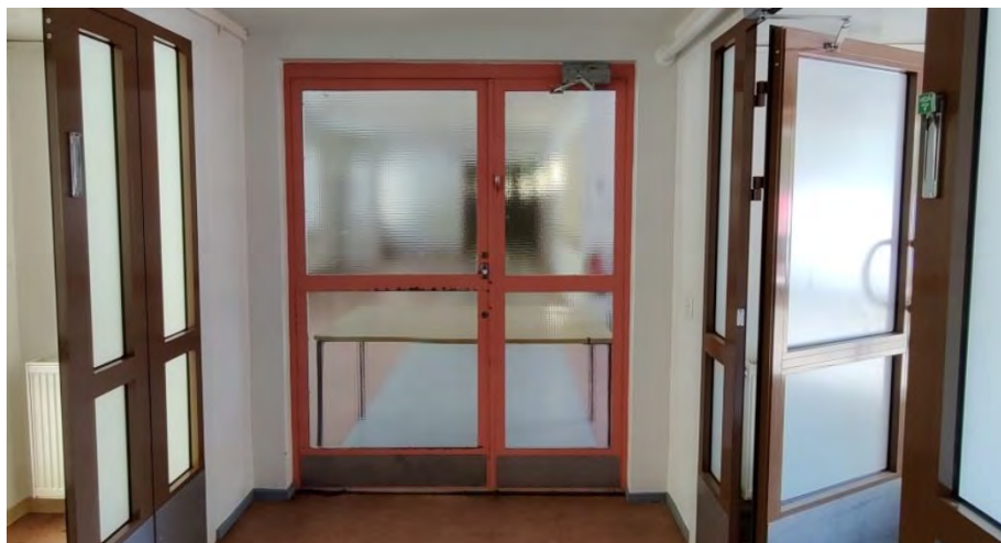
Kuva 120. Talo B, kulkuyhteys C-taloon. Oikealla ja vasemmalla tuulikaapit ja sisäänkäynnit etelään ja pohjoiseen.
