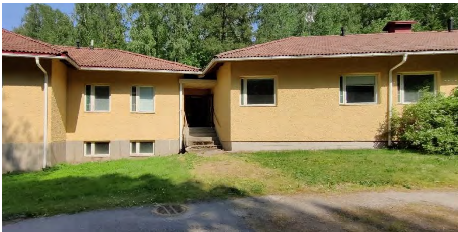
Kuva 96. Talojen C ja D välinen sisäänkäynti etelästä katsottuna. D-talon ikkunat ovat leveämpiä alkuperäisiä puuikkunoita. Sokkeliin on C-talon sokkelin korkeudella.
